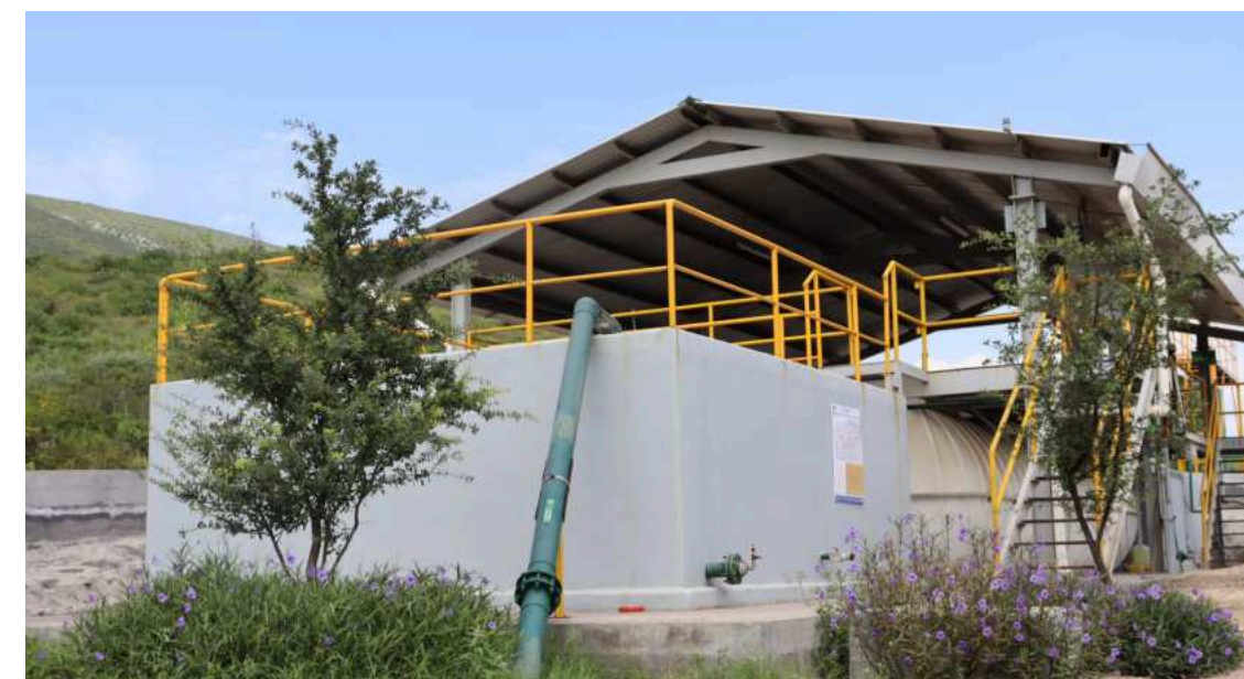
Planta de tratamiento de agua de Zinc Nacional
